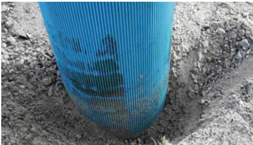
Fig. 27. Pozo sin cementar
