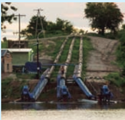
Sistema de bombas para riego
